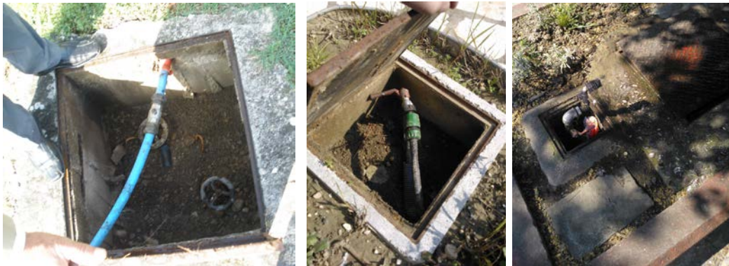
Εικ. 33 Πολλές όψεις της ίδιας κατάστασης: χειροκίνητες βάνες για άρδευση
